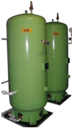
Tanques de aire
