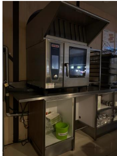
Horno Rational No tiene base, solo en Mueble y campana Colocada.
